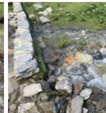
L'opera di presa danneggiata (foto G. Aimo)
