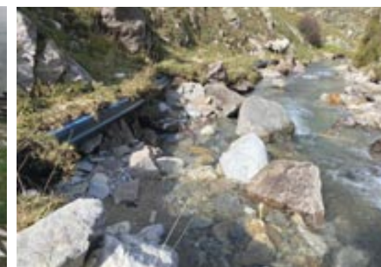
Danni all'opera di presa turbina del Rif. Mondovì (foto M. Canavese)
