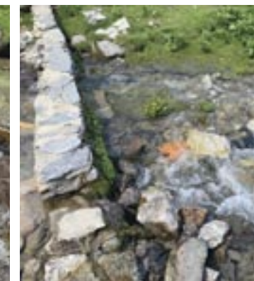
L'opera di presa danneggiata (foto G. Aimo)
